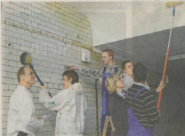
Viel Arbeit im Tunnel des Bahnhofgebäudes von Osterholz-Scharmbeck: Die Schüler Maik Bloom, Niklas Ruhnau, Alexander Krimmich und Erdal Ölge verschönern unter Anleitung ihres Lehrers Heiko Lange die Unterführung. Irene Maas schaut sich die von ihr angeschobene Aktion an. FOTO: FREI
