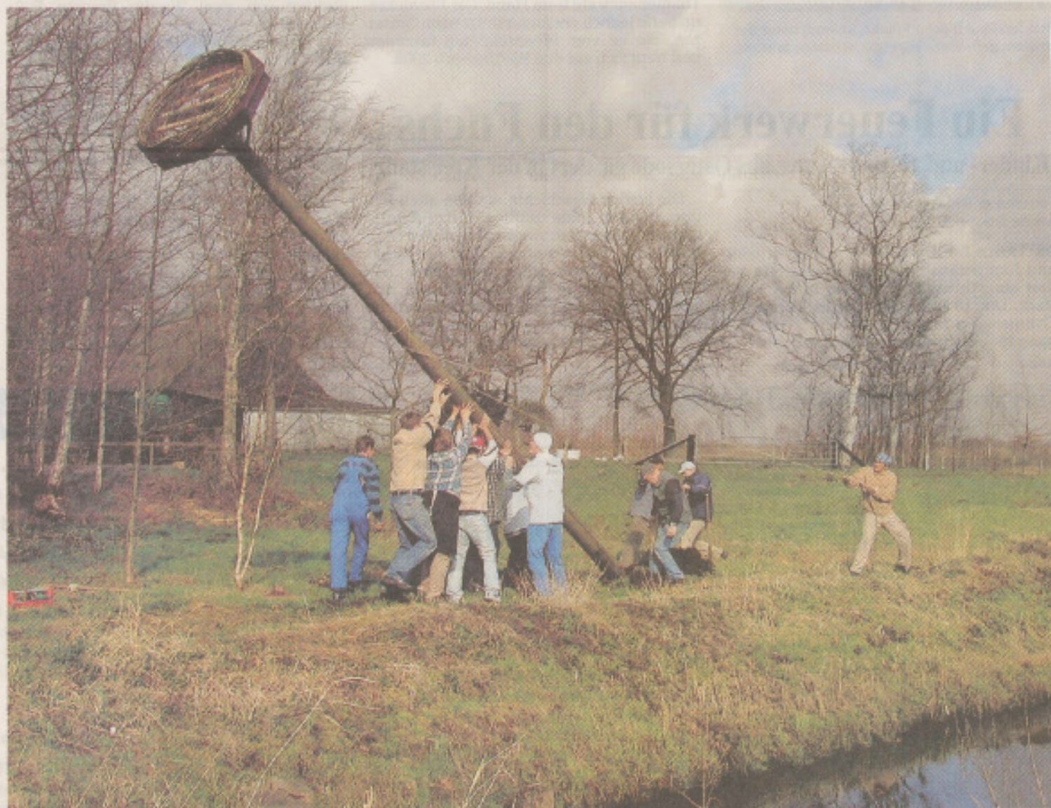
Das Eigenheim für Meister Adebar kurz vor der Fertigstellung: Schüler und Schülerinnen der Berufsbildenden Schulen haben zusammen mit Hansfried Ohlrogge vom Nabu einen neun Meter hohen Pfahlbau errichtet, auf dessen Spitze das Nest thront. FOTO: ANGELIKA MEURER-SCHAFFENBERG
